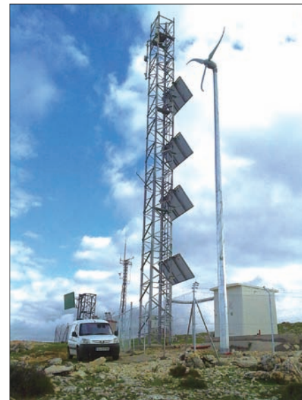
Estación Base TIC El Padrastró (Bogarra, Albacete). Telecom CLM (UNIRED)
