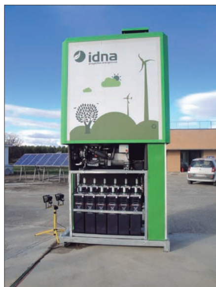
Sistema ABIC. Planta de ensayos del INTA en Torrejón de Ardoz (Madrid)
