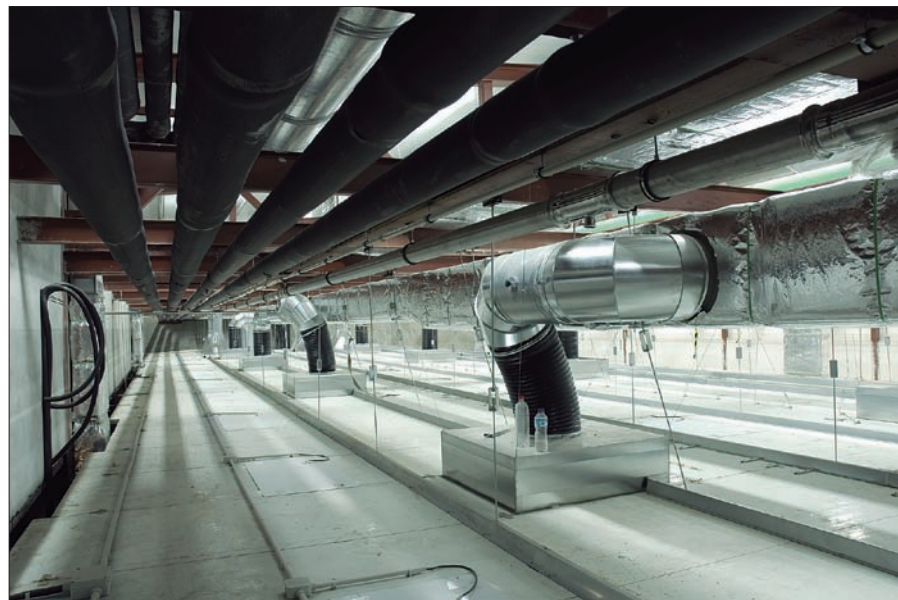
Climatización eficiente en industria
