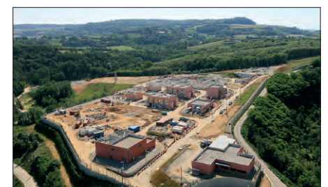
EPC Estación de compresión Oscar II (Saint Avit, Francia)
