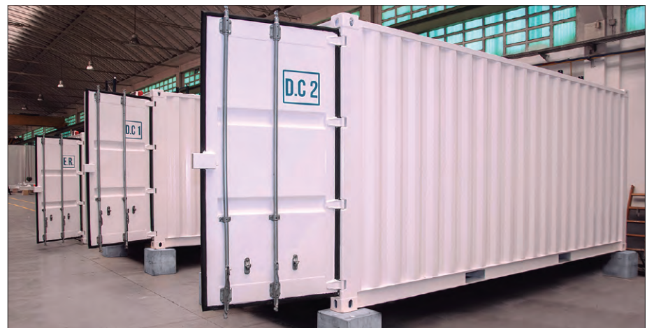
Centros de Procesos de Datos y Sala Eléctrica en revisión para su entrega
